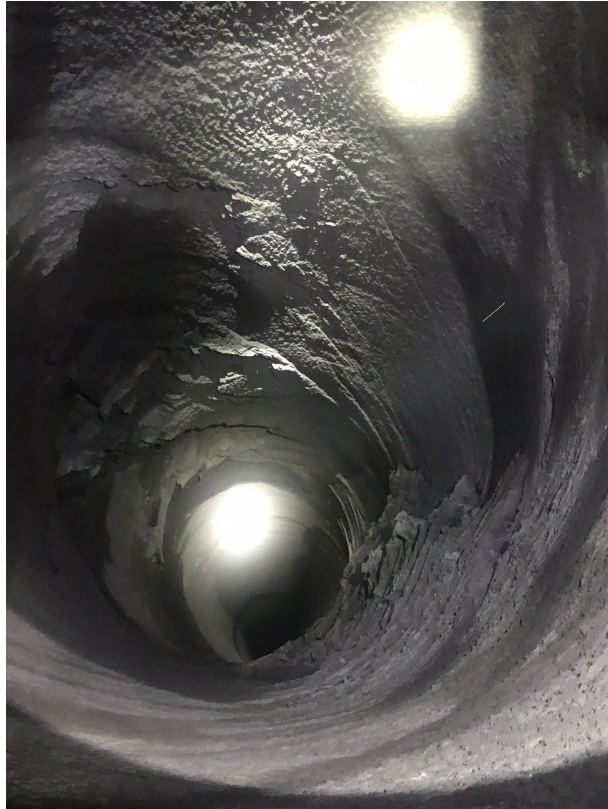
Figura A.5: Rotura chaminé
