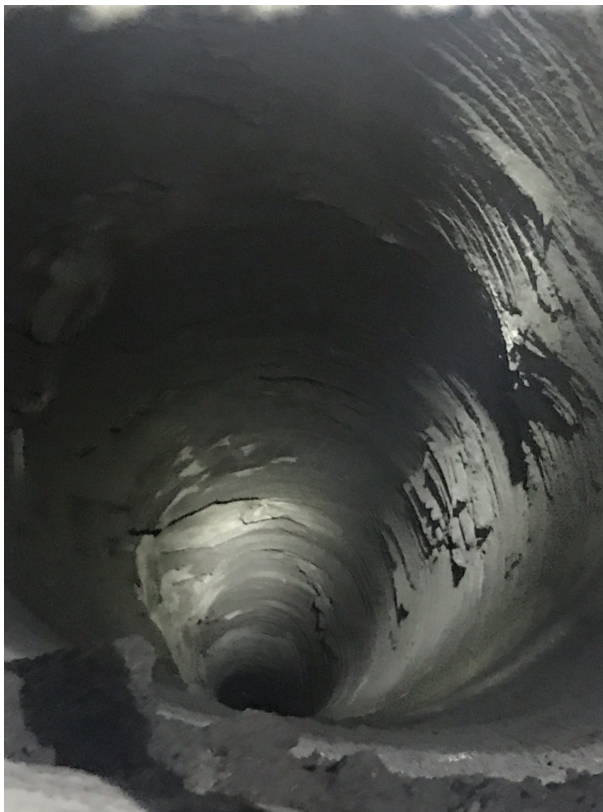
Figura A.4: Rotura chaminé
